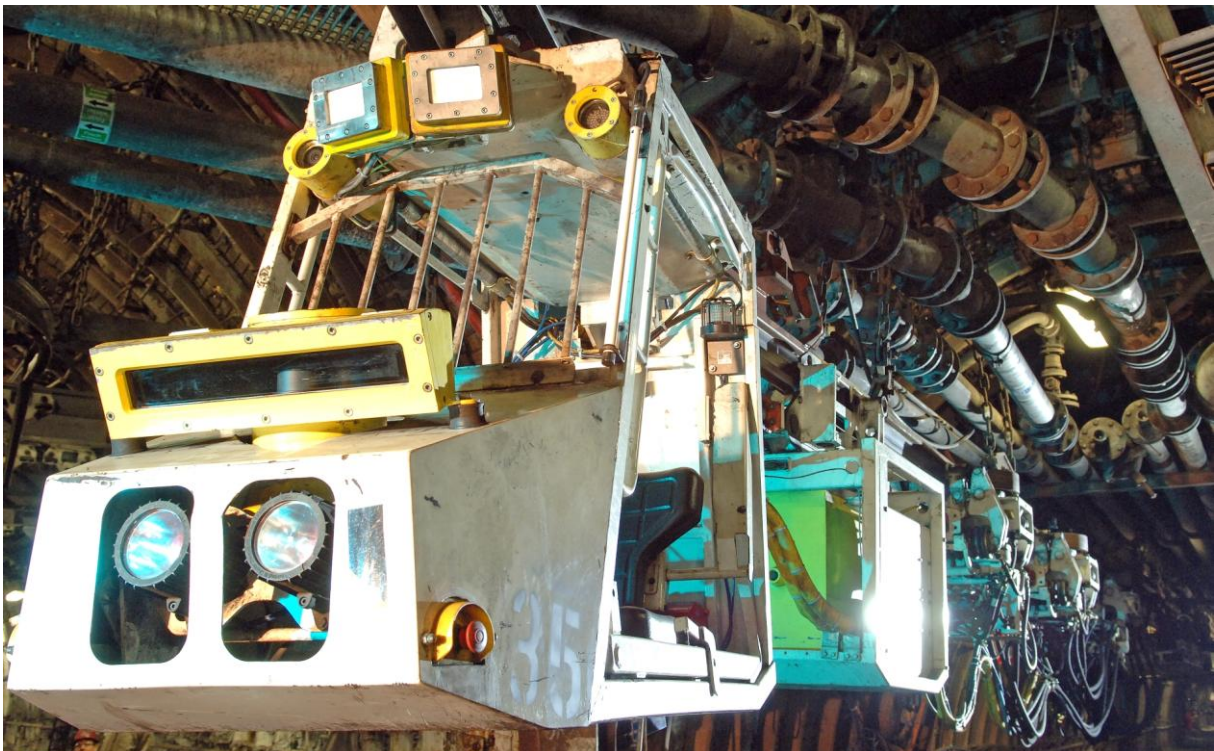
Abb. 1: Automatisierte Dieselkatze im Einsatz auf Bergwerk Ost
